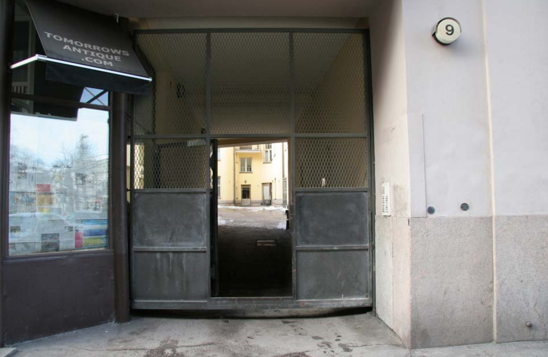
4. Pihan käyntiportti on liian kapea pyörätuolille ja lastenvaunuille. Alaosan poikkirauta estää osaltaan kulkemista portin läpi. (Lönrotinkatu)
