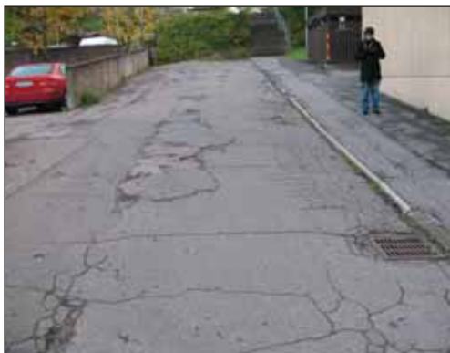
Hattelmalanpolulla on vakavaa päällystevauriota.
