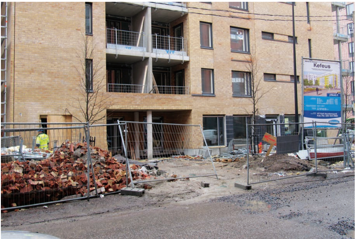
Esimerkkejä työmaavalvonnan puutteesta. Puut ovat vaarassa vaurioitua. Yllä MT. Alla PP.
