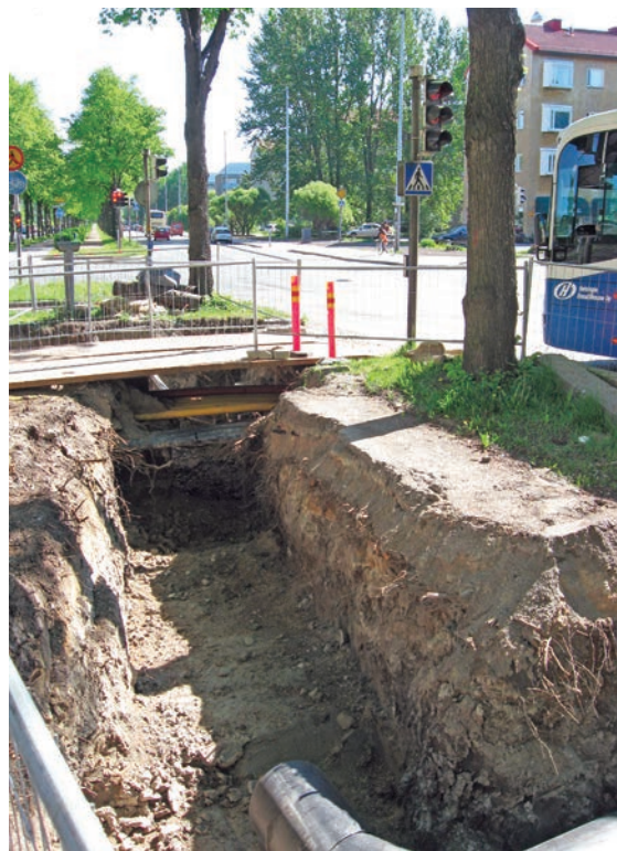
Kaivulupaohjeiden mukaan kaivannon reunan tulisi olla vähintään 2,5 metrin päässä rungon tyvestä. Kuva Koskelantieltä. MT.
