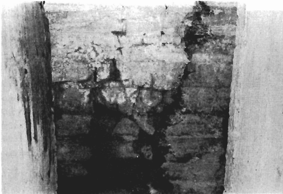
Kuva 25. Vettä vuotava halkeama vanhan metrovarauksen seinässä.
