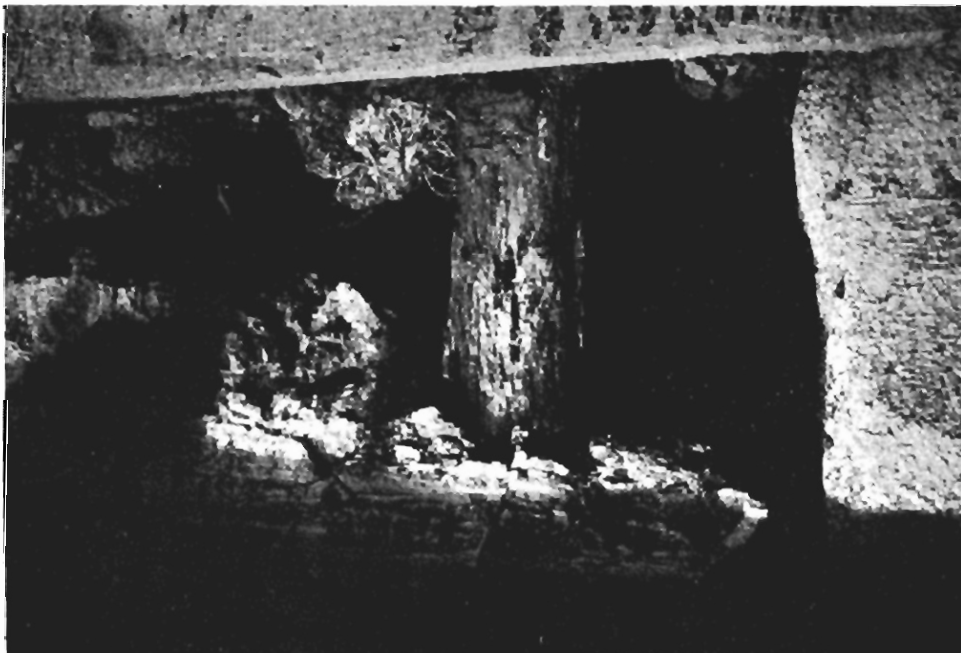
Kuva 14. Lahonnut puuperustuksen osa Aleksanterinkatu 11:n alla.
