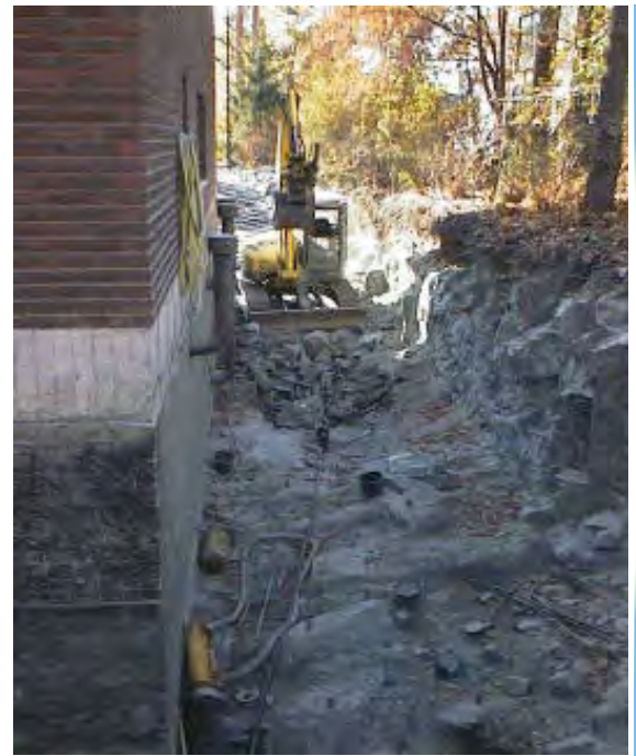
Salaojituksen puuttuminen on joskus syynä kosteusvaurioon. Salaojituksen rakentaminen voi pahimmillaan olla työlästä ja kallista.
